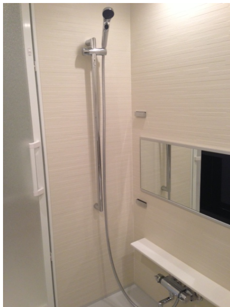
既存シャワーセット (ユニットバス)
